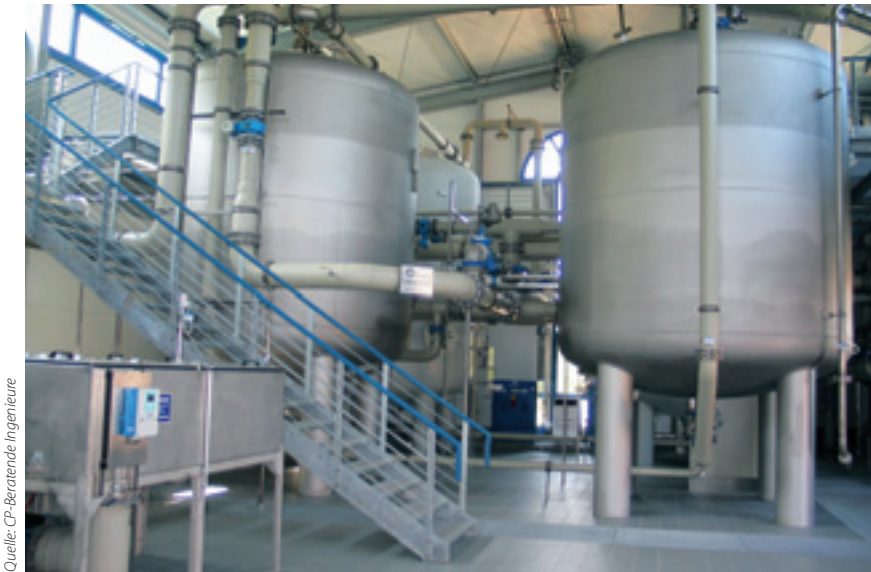
Abb. 7 Neue Aufbereitungsanlage im Wasserwerk Bexbach
