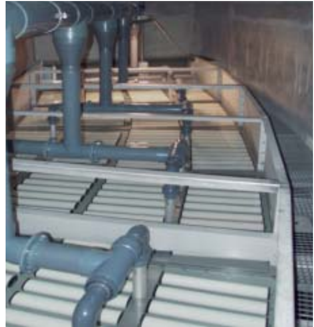
Entsäuerungsanlage Düsseldorf; 2.000 m 3 /h
