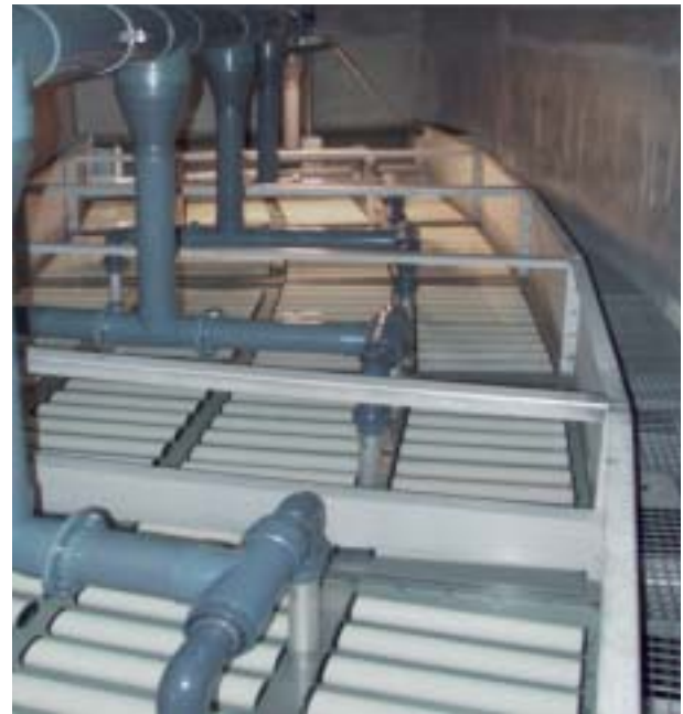
Entsäuerungsanlage Düsseldorf; 2.000 m 3 /h
