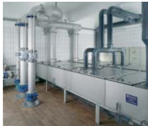
Entsäuerungsanlage Wiesbaden; 50 bis 500 m³/h
