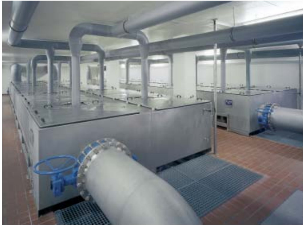
Entsäuerungsanlage Basel; Q_{\text{Wasser}} : 1.400 m 3 /h
