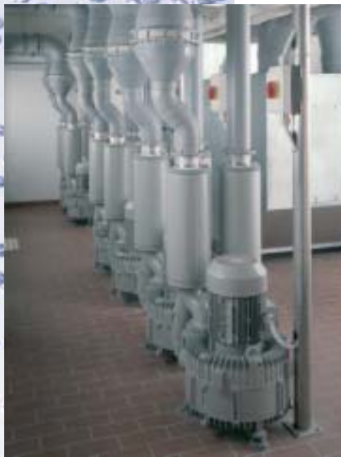
Basel; Verdichterstation mit Luftfilter
