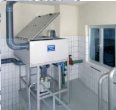
Entsäuerungsanlage Bad Camberg; 30 m 3 /h
