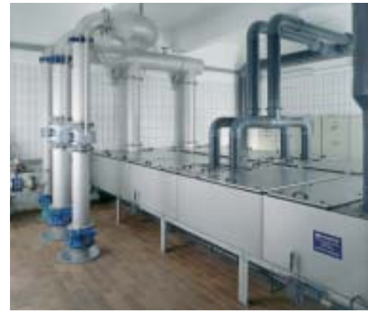
Entsäuerungsanlage Wiesbaden; 50 bis 500 m³/h
