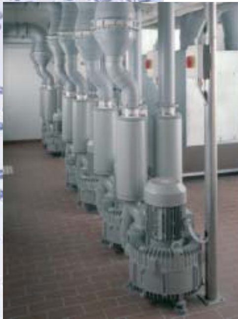
Basel; Verdichterstation mit Luftfilter
