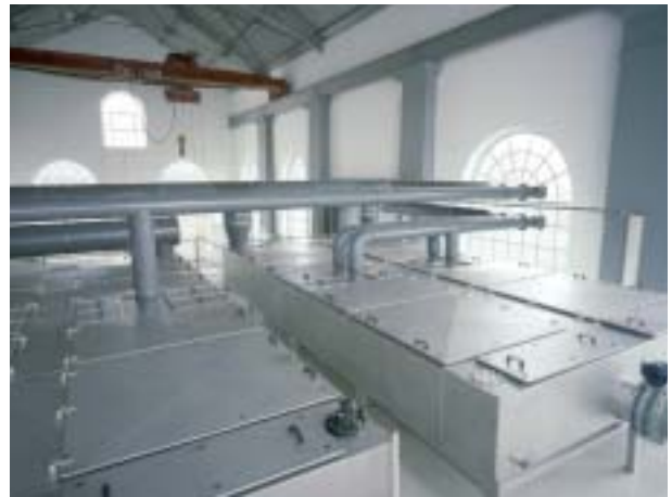
Entsäuerungsanlage Kassel; 2 x 300 m 3 /h
