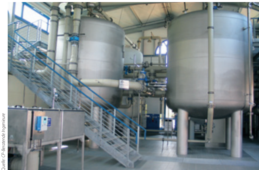
Abb. 7 Neue Aufbereitungsanlage im Wasserwerk Bexbach
